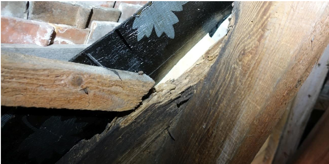
Ubytki elementów drewnianych, spowodowane przez grzyby.
