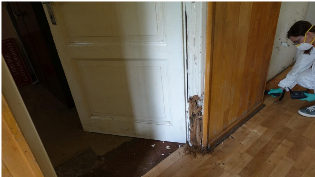
Ściany przy posadzce są mokre. Wilgoć, podciągana kapilarnie w murach, powoduje transport soli, które następnie niszczą tynki i powodują kruszenie wymalowań, a następnie tynku i muru.
