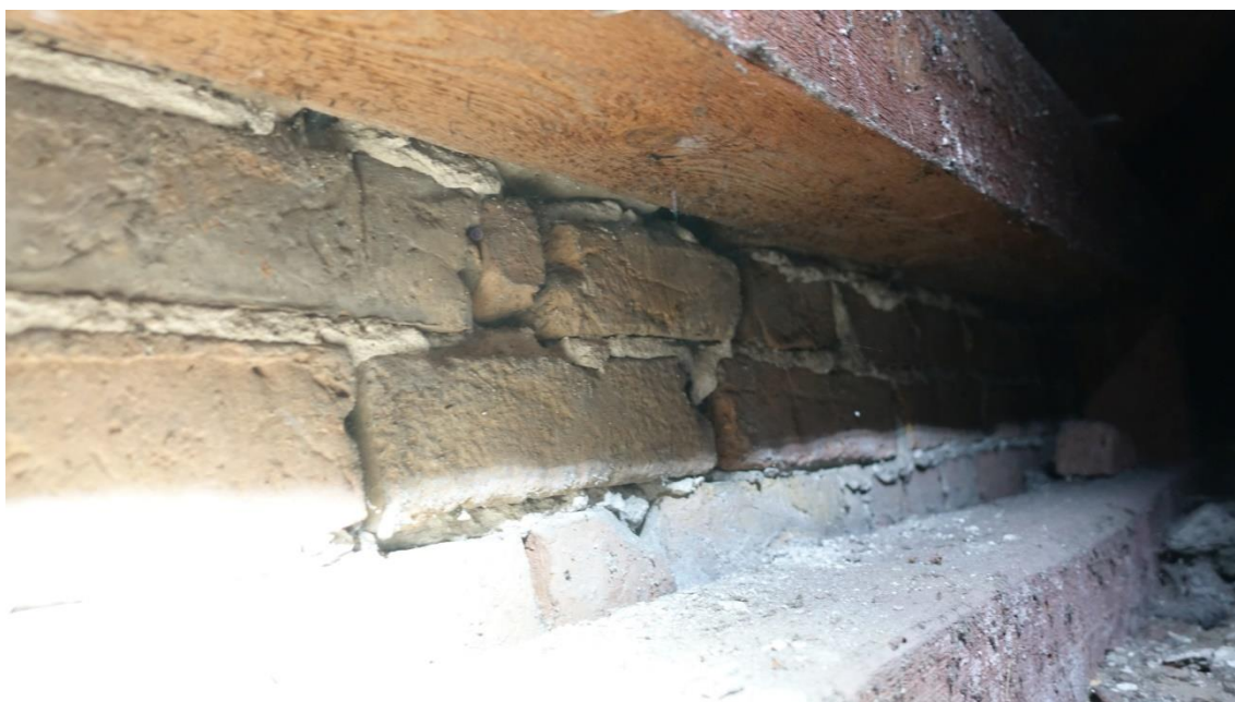
Brak izolacji pomiędzy drewnem a murami
