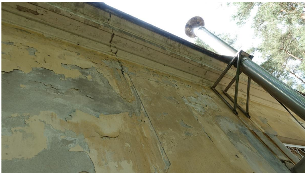
Kolejne pęknięcia pionowe, rozpoczynające się w górnej części gzymsu
