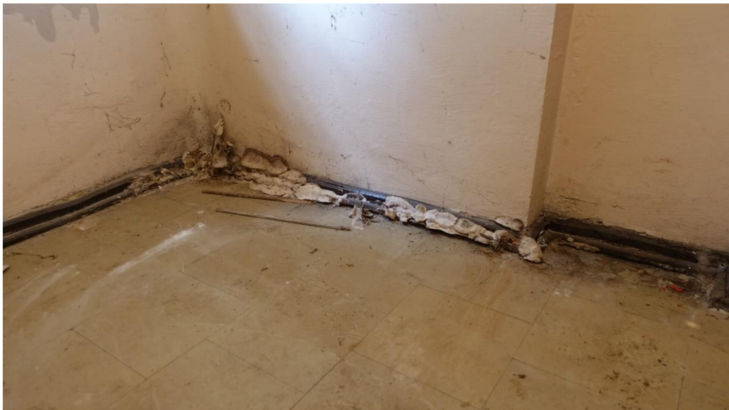
Wewnątrz pomieszczenia: owocniki grzyba domowego właściwego
