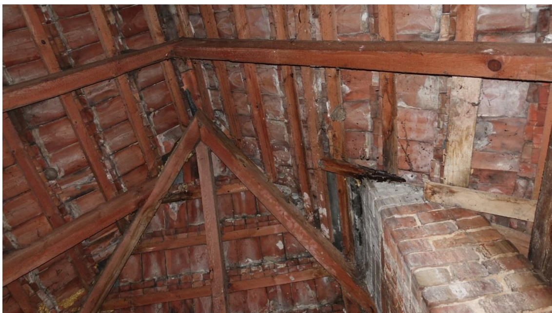
Widoczne nieszczelności przy kominie
