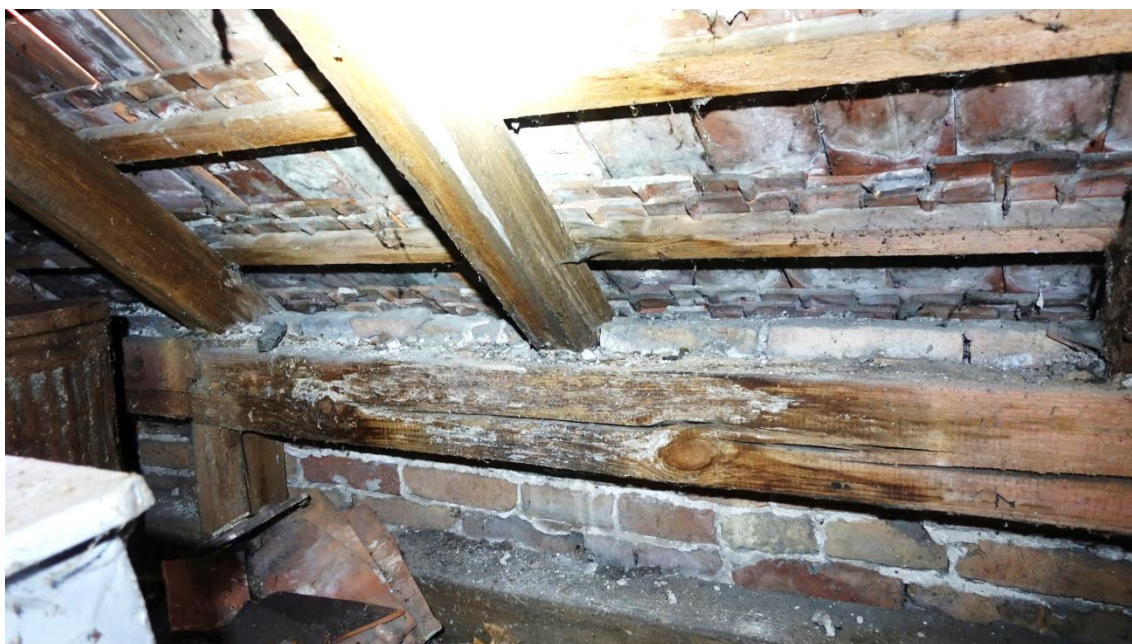
Ślady po zawilgoceniach – dotyczy to zarówno komina, jak też elementów więźby dachowej
