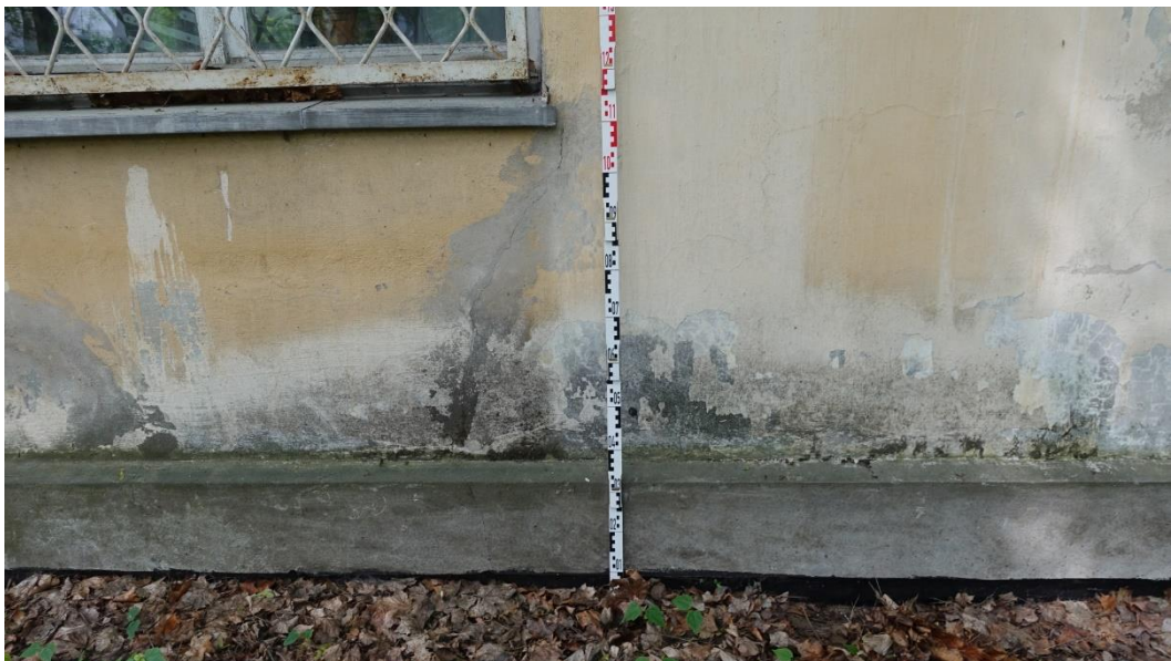
Cokół zawilgocony, mur zniszczony przez sole budowlane, nieszczelne połączenie obróbki blacharskiej z glifem okiennym (wys. około 1,1 m) spowodowało pęknięcie muru w tym miejscu, a następnie zwiększenie zakresu pęknięcia aż do wysokości cokołu. Zostało to spowodowane zjawiskiem rozsadzania solami budowlanymi, ale także zamarzaniem i rozmarzaniem wody zgromadzonej w szczelinie.
