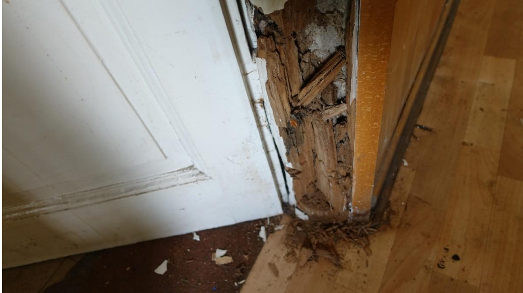
Skutek działalności grzyba domowego właściwego: rozpad drewna. Wejście do gabinetu, znajdującego się w północno - zachodnim ryzalicie
