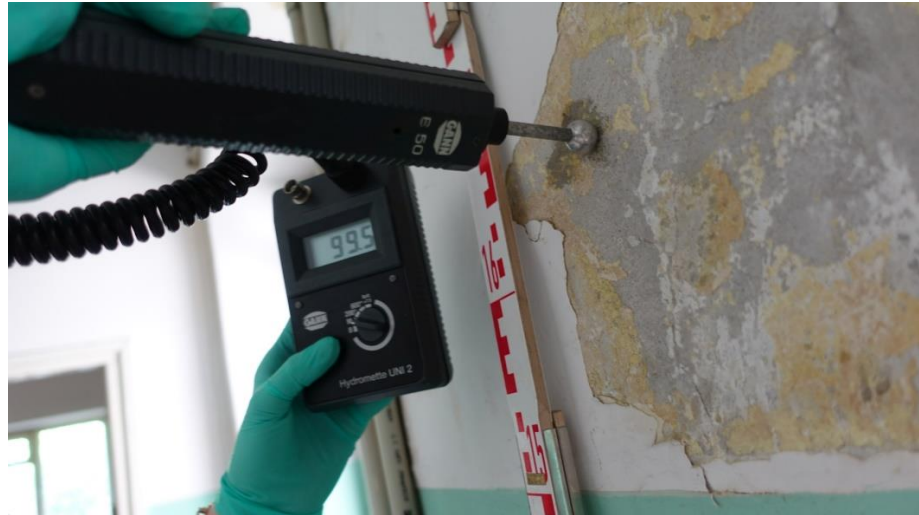
Pomiar wilgotności ściany w kolejnym miejscu wykonany za pomocą miernika Hydromette UNI 2 GANN – ściana jest mokra.
