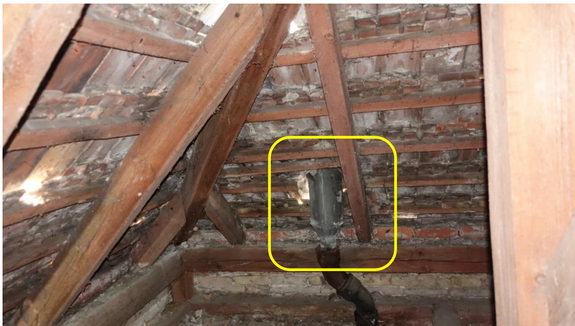
Odpowietrzenie rury kanalizacyjnej jest wyprowadzone w przestrzeń strychu
