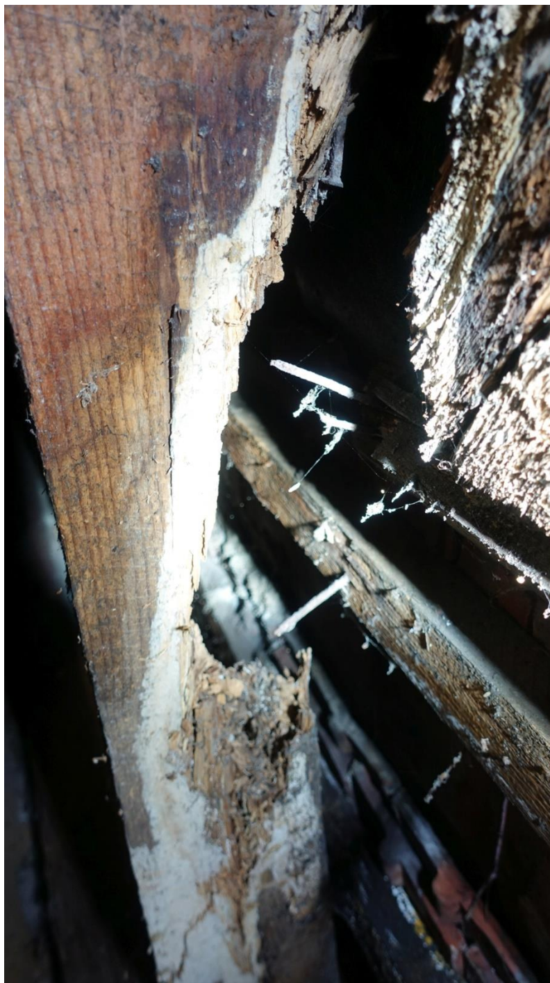
Znaczny ubytek drewna w wyniku działania grzybów
