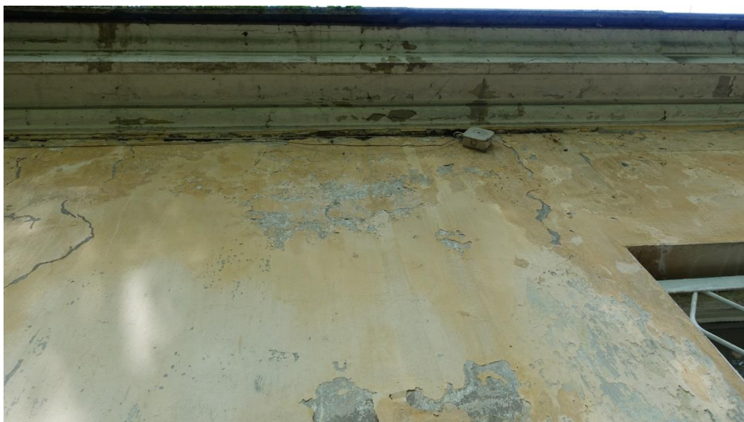
Zbliżenie na pęknięcia elewacji i gzymsu
