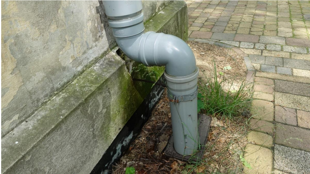
Zawilgocony cokół pokrył się glonami. Izolacja widoczna pod cokółem nie spełnia swojej funkcji.
